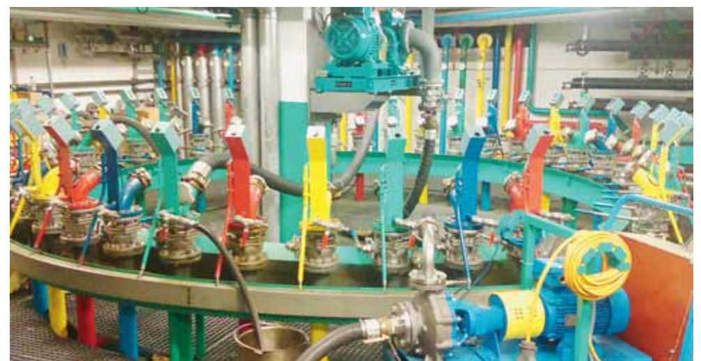
C'est dans cette centrale qu'aboutissent les différentes huiles de base, avant d'être acheminées pour la fabrication à travers 200 km de tuyauterie que compte l'usine. PH. OUDOT
