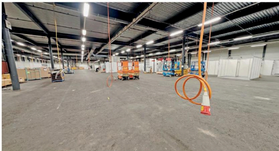
Cinq semaines de travaux sont nécessaires avant que le SIAMS ne prenne ses quartiers au Forum de l'Arc.
